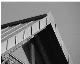
Fig. 12: Fluktende møneavslutning på vindskibeslag falset, lav utførelse
