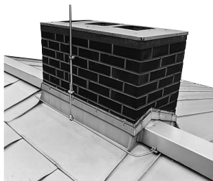
Fig. 8: Lynvern-innretning på en pipehatt med avleder
